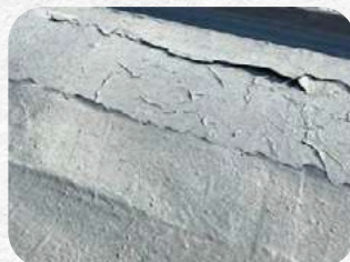
PINTURA DESCASCARADA Y GRIETAS
